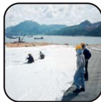
TKO, Hong Kong Wasserdränung einer Mülldeponie
